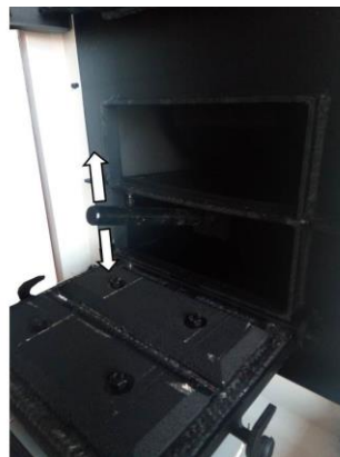
Малюнок 19. Очищення турбуляторів на котлі
